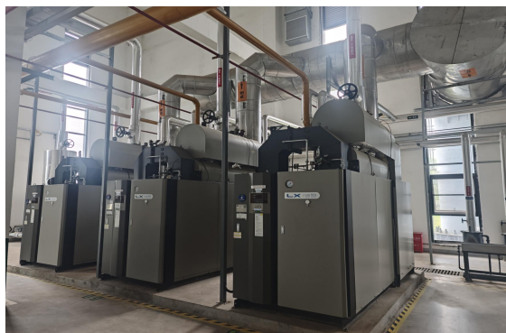
3 台 4t/h 燃气锅炉（备用）
