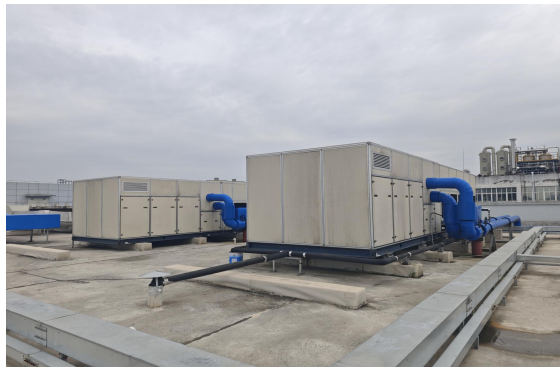
动物实验中心空调通风系统
