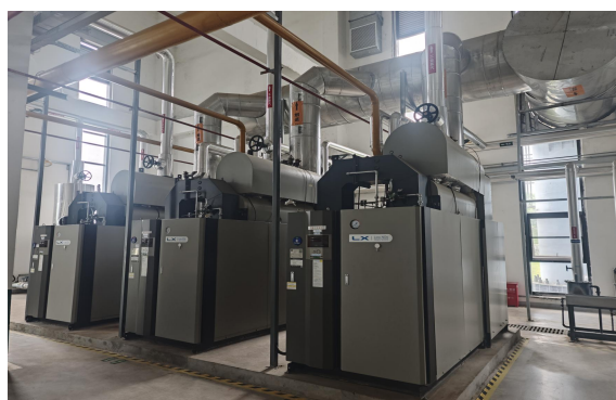
3台 4t/h 燃气锅炉（本项目新增，备用）
