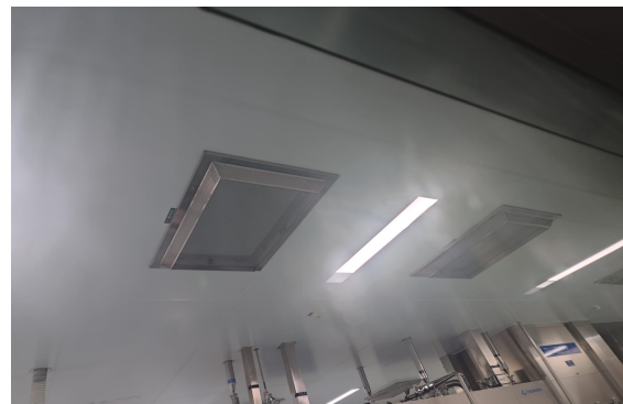
冻干制剂净化空调初净化（高级）
